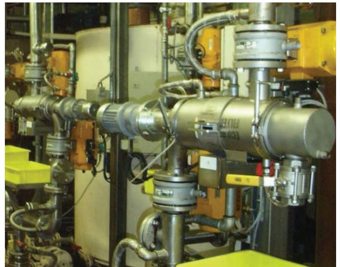
Figure 1: Les filtres autonettoyants Russell Self-Cleaning Eco Filter® installés sur le site de Godiva en Belgique
