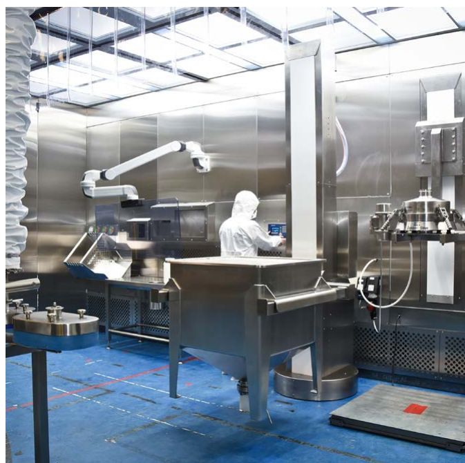
Figuur 2. Installatie van de Russell Compact Sieve® in een ETL downflow cabine
