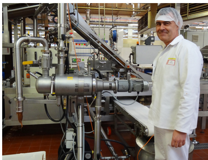
Figura 1. Filtro Autolimpante Russell Eco Filter® instalado na planta de produção da Mondelez em Herentals, Bélgica.
