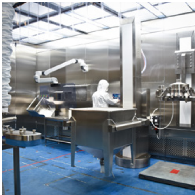
Figura 2. Instalação da Russell Compact Sieve® instalada na cabine de contenção da ETL
