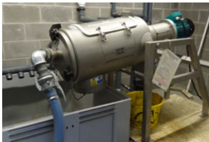
Figura 1. O Russell Liquid Solid Separator™ instalado no centro de reabilitação de equinos para limpar a água
