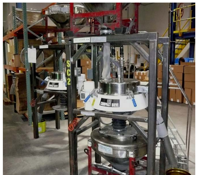
Foto 1. Russell Compact Sieves® installiert bei Deloro Stellite in Indiana
