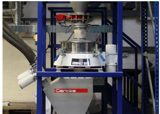
Bild 1. Eines der Russell Compact Sieve® Siebmaschinen unter einem Trichter bei Altro installiert.
