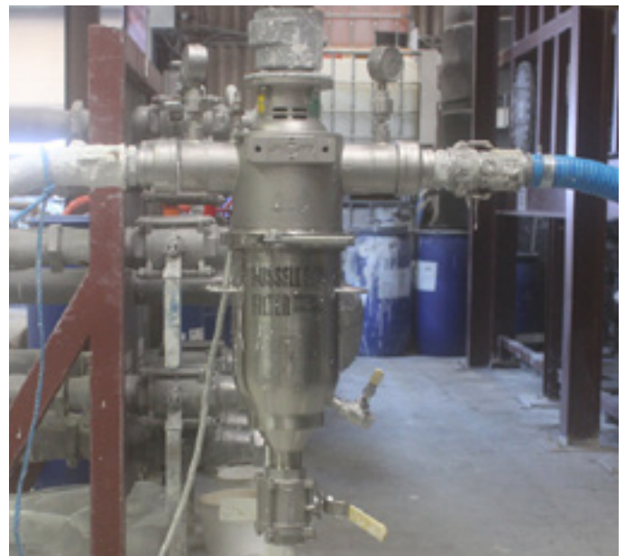
Figure 1. Der Self-Cleaning Russell Eco Filter® wird bei Farrow & Ball installiert, um nicht dispergierte Pulverpigmente aus der Farbe zu entfernen.
