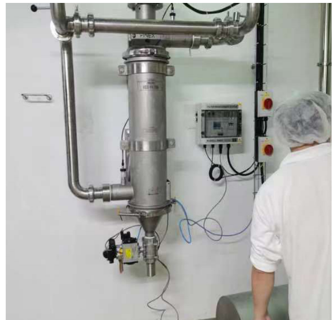
Abbildung 2 Die Installation des Selbstreinigenden Russell Eco Filters®
