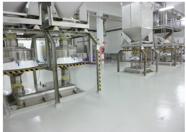
Figura 1. Russell Compact Sieves® instaladas en la nueva fábrica de leche en polvo en Chile
