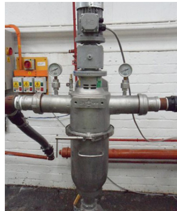
Figura 1. Filtro Russell Eco Filter® instalado en Angus Fire
