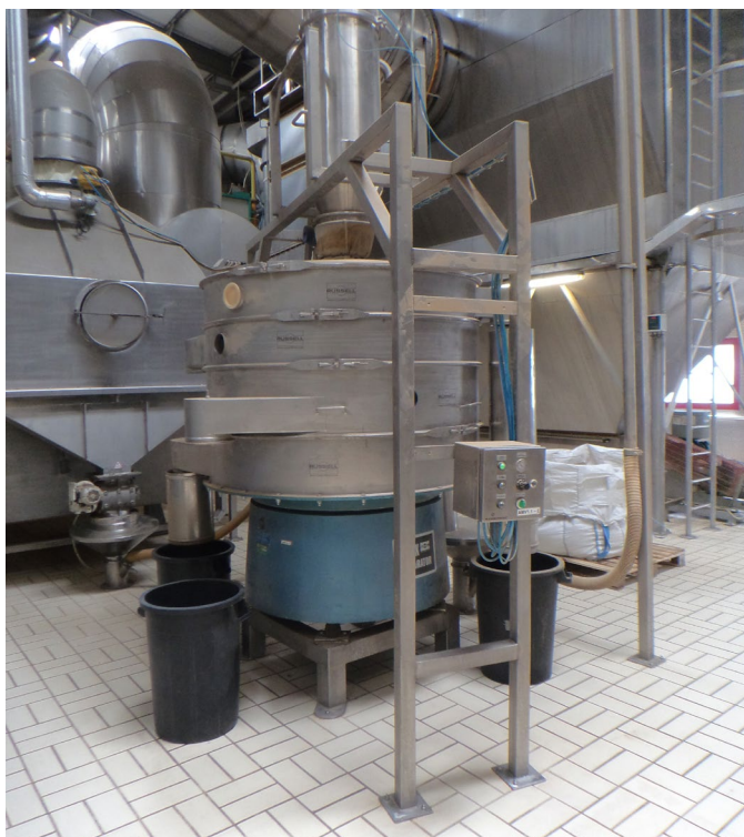
Figura 2. Un Finex Separator™ adicional instalado en la línea de producción de Haitoglou Bros SA
