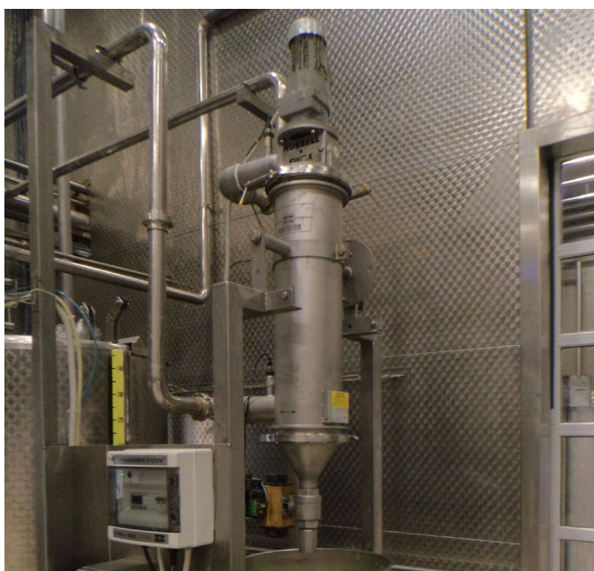
Figura 4. Un Self-Cleaning Russell Eco Filter® en línea instalado en Haitoglou Bros SA para garantizar una calidad consistente de la pasta tahini
