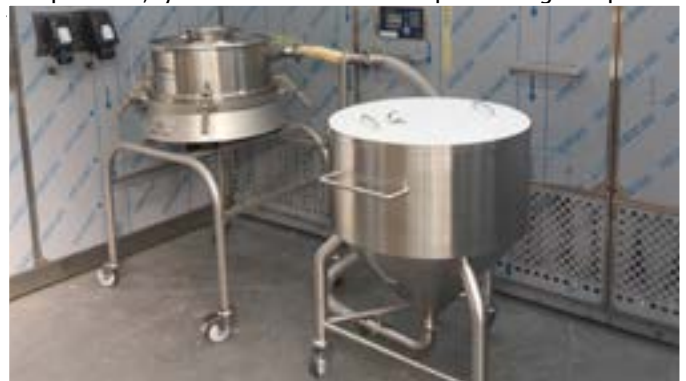
Imagen 3. Russell Compact Airswept Sieve™ instalado en una cabina de contención WORKSAFE™ de Howorth
