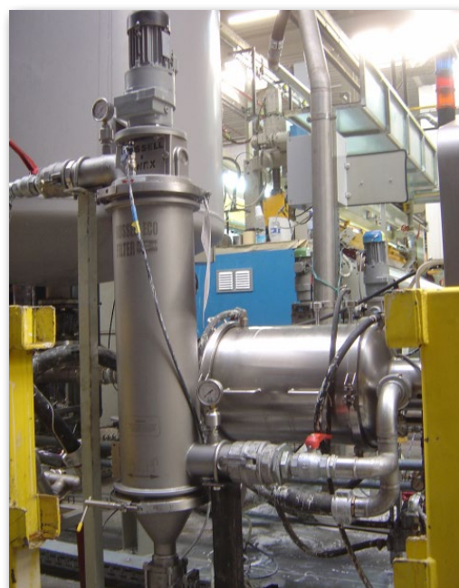
Figur 1: Einer von vier Self-Cleaning Russell Eco Filters® die in der Cushion Vinyl-Verarbeitungslinie installiert sind
