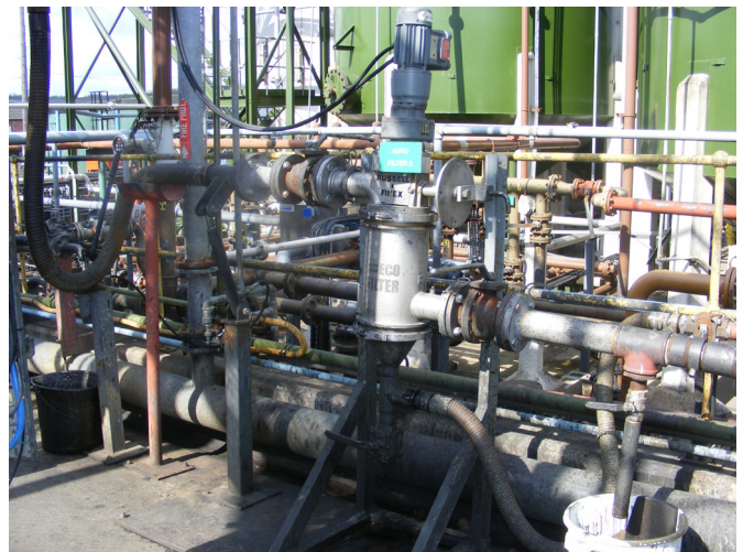
Figure 1. Filtre autonettoyant Russell Eco Filter® installés chez Veolia
