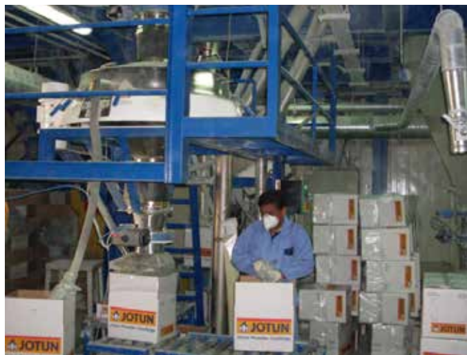
Figure 3 : Le Russell Compact Sieve® installé avant les lignes de remplissage chez Jotun UAE.
