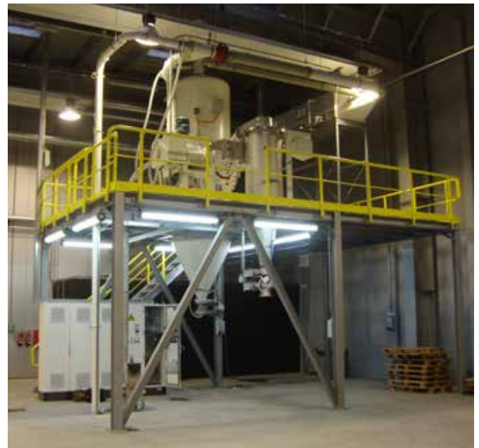
Figure 2 : Installation type fournie à Neuman & Esser, l'opération de tamisage étant positionnée sous le cyclone classificateur, avant les lignes de remplissage.
