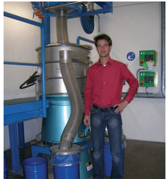
Eén van de geïnstalleerde Finex Separators™ bij Treibacher
