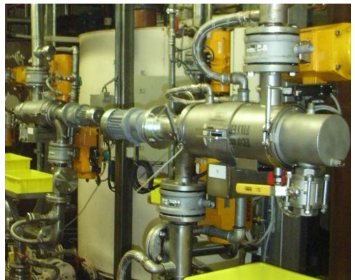
Afbeelding 1. Russell Self-cleaning Eco Filters®, geïnstalleerd in de Godiva-fabriek in België
