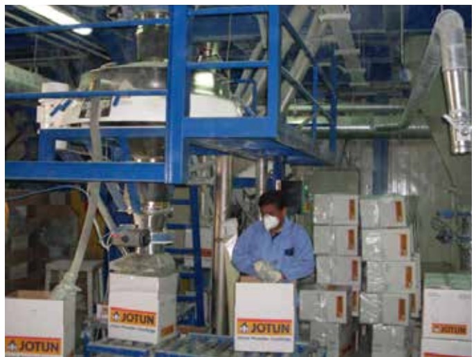
Afbeelding 3: De Russell Compact Sieve®, geïnstalleerd vóór de vullijnen bij Jotun UAE.
