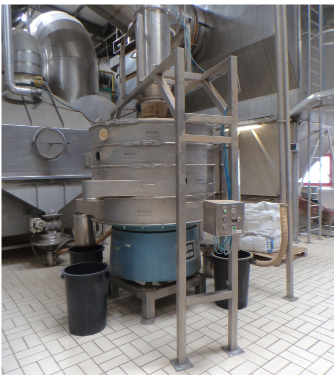
Figure 2. Dodatkowy Finex Separator™ zainstalowany w linii produkcyjnej Haitoglou Bros SA
