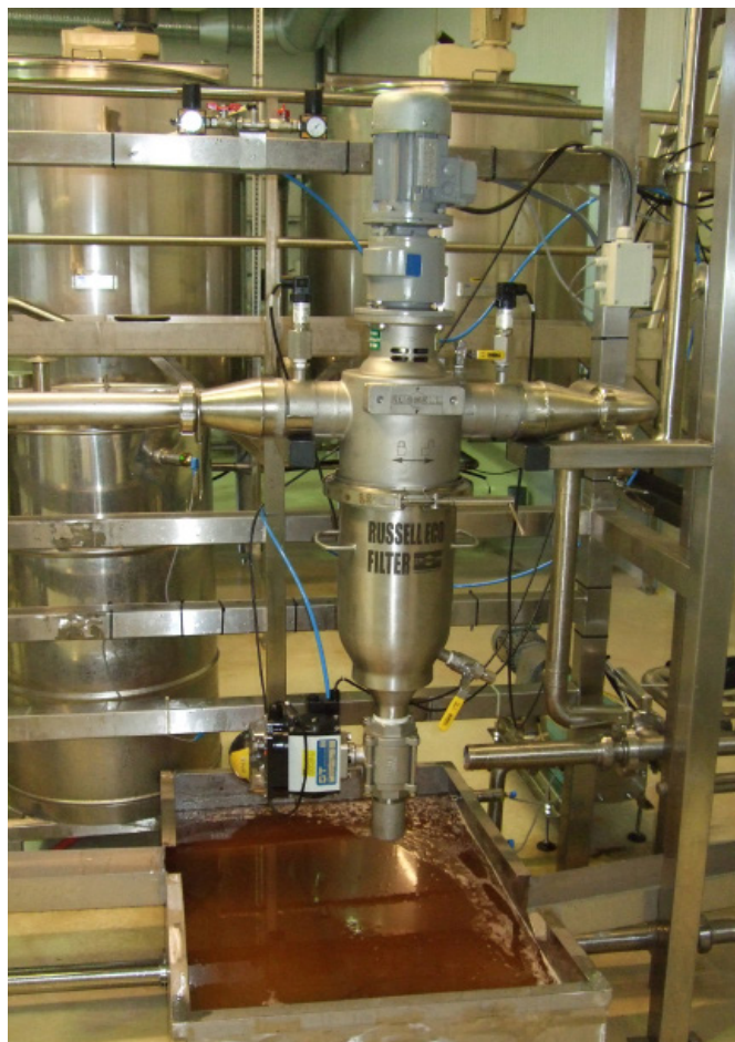
Zdjęcie 2: Zainstalowany filtr samoczyszczący Russell Eco Filter®
